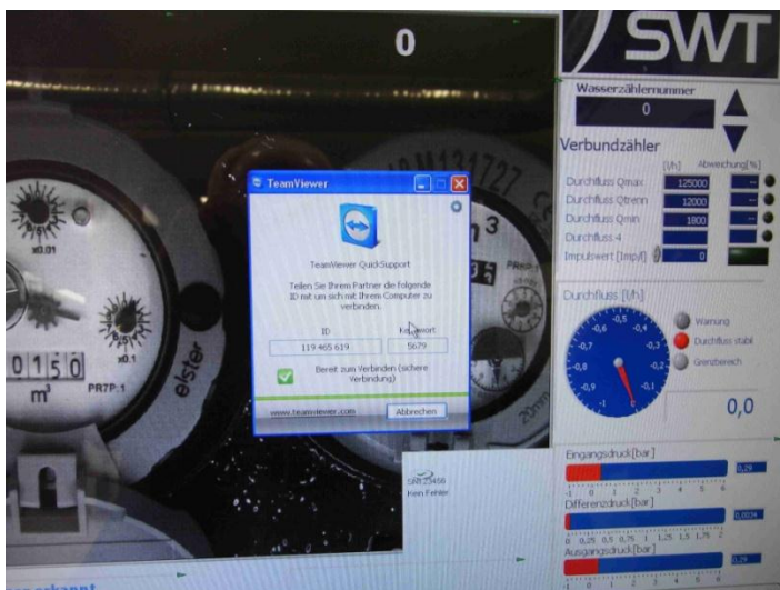
Bedienerterminal eines Kaltwasserzählerprüfstandes bei der Staatlich anerkannten Prüfstelle WK 4 bei den Stadtwerken in Trier
